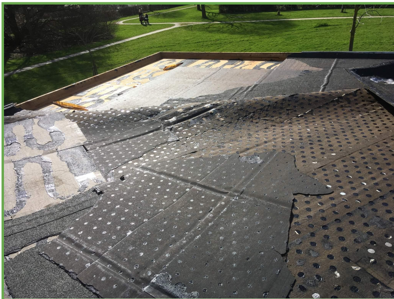
Het dak van verenigingsgebouw was volledig los gewaaid.
